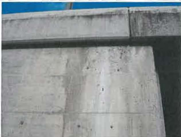
CuGa6 Mur de culée gauche Massongex 301 Zones humides A l'extérieur de la culée, sous la bordure du tablier. Trace de coulure blanches.
