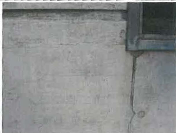
CuGa0 Mur de culée gauche Bex T2110 Fissures importantes supérieures à 0.3 mm A l'extérieur de la culée, aux angles de la porte d'accès. Fissures horizontales et verticales aux angles supérieur droit et inférieur gauche.
