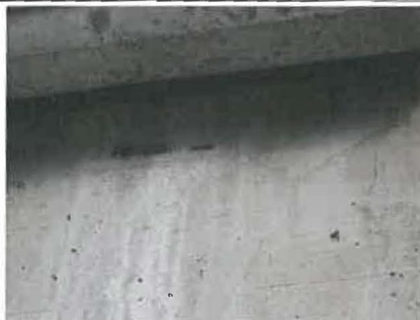
CuGa0 Mur de culée gauche Bex 2204 Armature légèrement corrodée A l'extérieur de la culée, sous la bordure du tablier. Armature apparente et corrodée + traces de coulures blanches.
