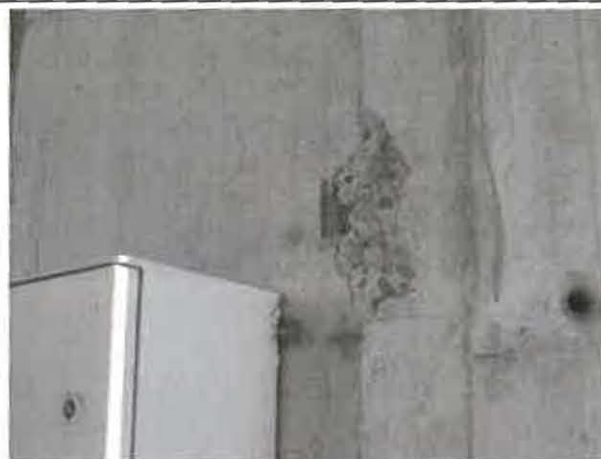
PiGa3 Pile 3 gauche 1322 Ecaillages, cloques A hauteur d'oeil, face St-Maurice et Lausanne. 2 éclats de béton sans armature apparente.
