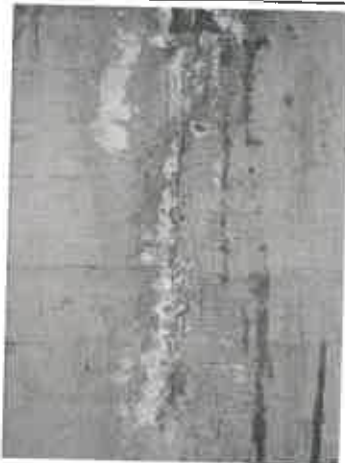
Cu0 Culée côté Bex T2110 Fissures importantes supérieures à 0.3 mm Mur arrière de culée, à l'intérieur du couloir de visite. Joint de reprise de bétonnage vertical à mi-longueur du mur. Joint de repise de bétonnage fissuré avec efflorescences.
