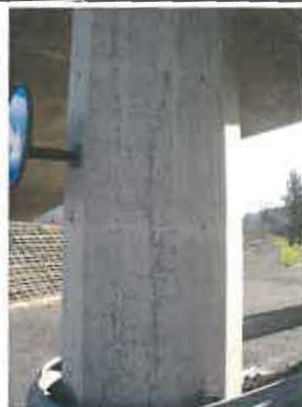
PiDr3 Pile 3 droite 1322 Ecaillages, cloques Face Massongex-Lausanne. Ecaillage de la surface de béton.
