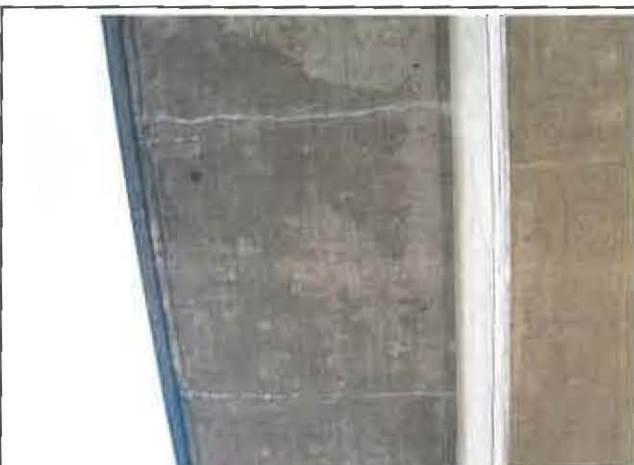
Ta Dalle supérieure du caisson T2110 Fissures importantes supérieures à 0.3 mm Face inférieure de la dalle de roulement. Côté droit, entre Pi2 et PiDr3. Plusieurs fissures en travers avec efflorescence.
