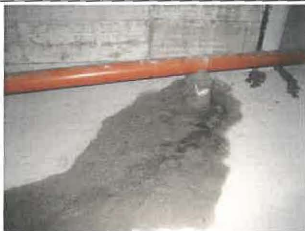
CoDr Conduites droites T4101 Conduites détériorées A l'intérieur du caisson, entre Ent2 et Ent3. Défaut d'étanchéité, venue d'eau.
