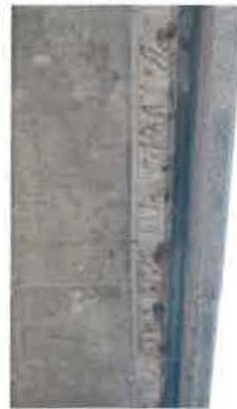
Ta Dalle supérieure du caisson 2204 Armature légèrement corrodée Face inférieure de la dalle de roulement, entre la retombée de la bordure et la goutte pendante, côté gauche et droite. Trace de coulures, taches de rouille, éclats de béton et armatures apparentes. Dégât fréquent sur toute la longueur de l'ouvrage.
