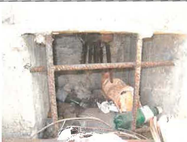
Cu0 Culée côté Bex 2205 Armature fortement corrodée Banc de culée, face extérieure, au pied du mur, côté droit. Niche de précontrainte verticale non cachetée. La tête de précontrainte et les totons ne sont pas protégés.
