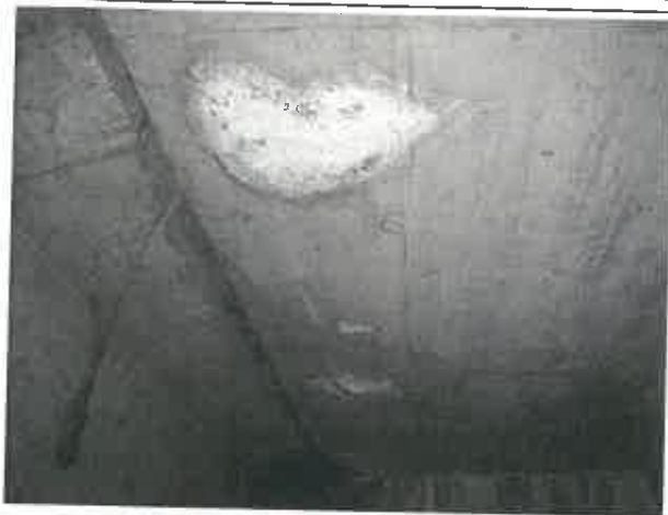
Cu0 Culée côté Bex 301 Zones humides Dalle du couloir de visite, côté droit. Traces d'humidité, efflorescences (3x).
