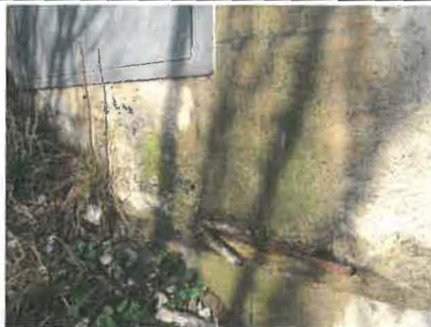
CuGa6 Mur de culée gauche Massongex 509 Enrobage d'armature insuffisant A l'extérieur de la culée, sous la porte d'accès. Eclat de béton avec armature apparente, corrodée et cassée.
