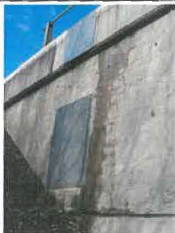
Jo6 Joint de chaussée Massongex 319 Joint non étanche Aux extrémités gauche et droite du joint. Importantes traces de couleure contre les murs de culée gauche et droite, au droit du joint de chaussée.
