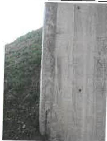
Cu0 Culée côté Bex T2110 Fissures importantes supérieures à 0.3 mm Banc de culée, face extérieure, angle avec CuDr0. Sur toute la hauteur du mur de culée. Fissure importante à l'angle du mur. Eclat de béton au pied du mur avec armature apparente et légèrement corrodée.
