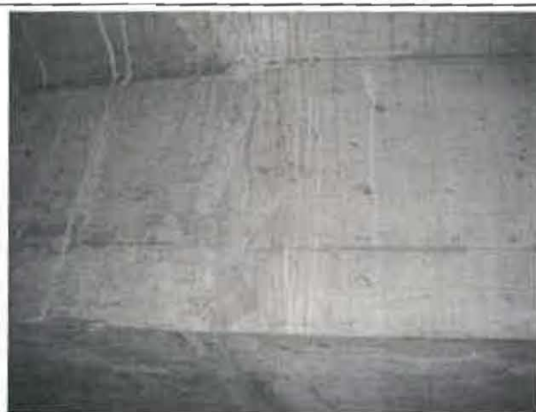
Ta Dalle supérieure du caisson T2110 Fissures importantes supérieures à 0.3 mm A l'extrémité du tablier, dans le couloir de visite de Cu0. Fissure sur la face verticale se prolongeant en sous-face.
