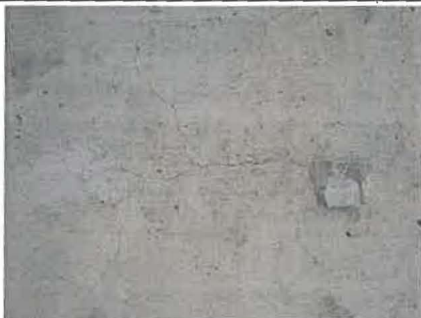
CuGa0 Mur de culée gauche Bex 1322 Ecaillages, cloques A l'extérieur de la culée, sur toute la surface du mur. Fissuration, écaillage de la surface de béton.
