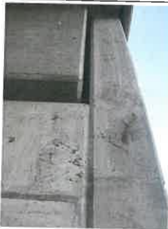
Cu6 Culée côté Massongex 2205 Armature fortement corrodée Banc de culée, face extérieure. A l'angle avec CuDr6. Epaufrures, éclats de bétons avec armature apparente et corrodées.
