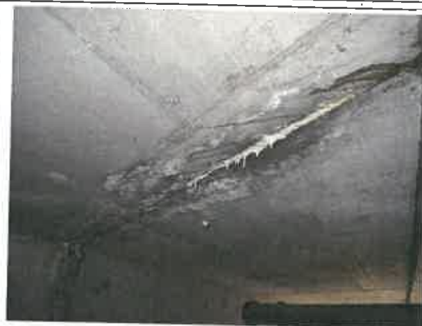
Cu0 Culée côté Bex T2110 Fissures importantes supérieures à 0.3 mm Dalle du couloir de visite, au centre de l'ouvrage. Joint de reprise de bétonnage fissuré, avec traces d'humidité et efflorescences.
