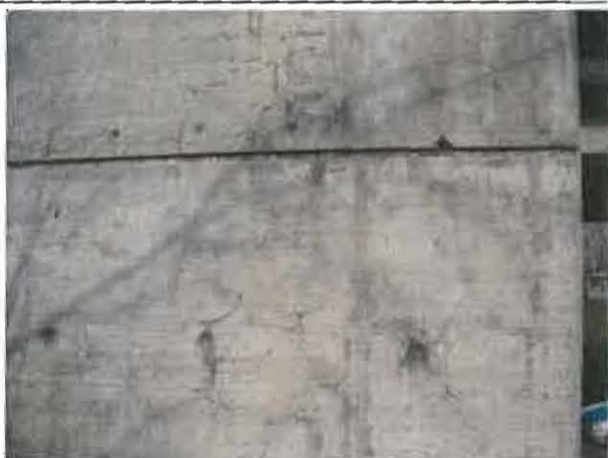
CuGa6 Mur de culée gauche Massongex 1322 Ecaillages, cloques A l'extérieur de la culée, sur toute la surface du mur. Fissuration verticale et horizontale de la surface du mur + 1 éclat de béton vers lisse, sans armature apparente.
