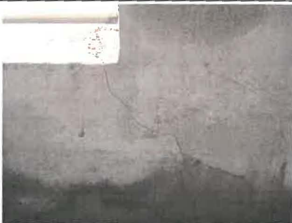
CuGa0 Mur de culée gauche Bex T2110 Fissures importantes supérieures à 0.3 mm A l'intérieur du couloir de visite, vers porte d'accès. Fissures en biais aux angle supérieur gauche et inférieur droit de la porte d'accès.
