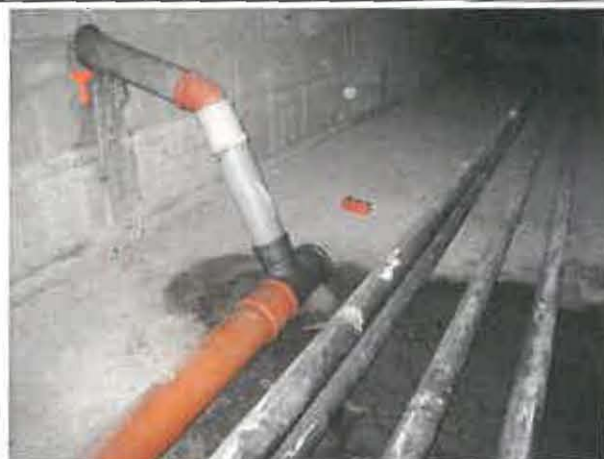
CoGa Conduites gauches T4101 Conduites détériorées 2 ème entrée depuis Ent1 en direction de Massongex. Défaut d'étanchéité, venue d'eau.
