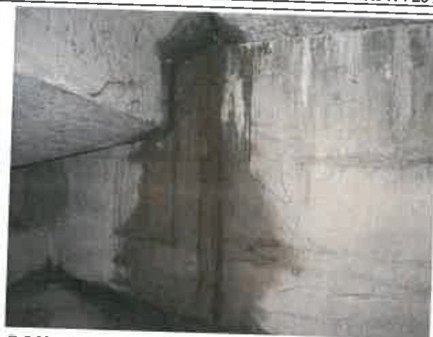
CuDr0 Mur de culée droit Bex 301 Zones humides A l'intérieur du couloir de visite. Traces importantes d'humidité au droit du joint de chaussée.
