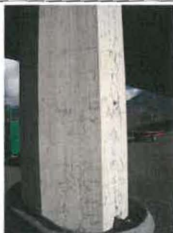
PiGa5 Pile 5 gauche 1322 Ecaillages, cloques Faces St-Maurice, St-Maurice-Bex et St-Maurice-Massongex. Ecaillage de la surface de béton.
