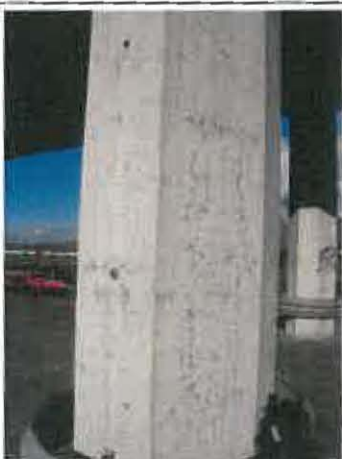
PiGa4 Pile 4 gauche 1322 Ecaillages, cloques Face St-Maurice et St-Maurice-Bex. Ecaillage de la surface de béton.
