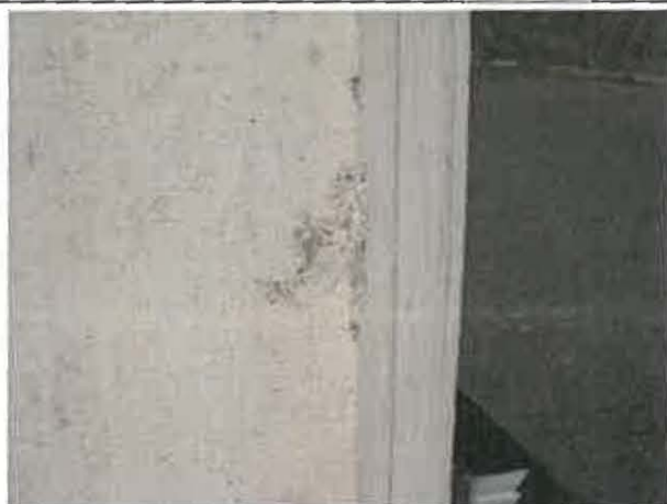
PiGa3 Pile 3 gauche 1322 Ecaillages, cloques A hauteur d'oeil, face St-Maurice et Lausanne. 2 éclats de béton sans armature apparente.
