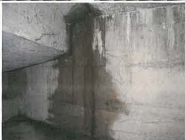
Jo0 Joint de chaussée Bex 319 Joint non étanche Aux extrémités gauche et droite. Importantes traces de coulure sur les murs de culée gauche et droite au droit du joint de chaussée (intérieur + extérieur).
