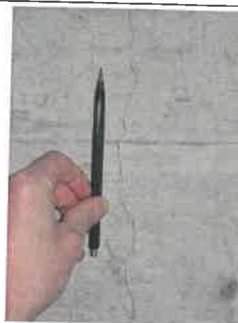
Cu0 Culée côté Bex T2110 Fissures importantes supérieures à 0.3 mm Mur arrière de culée, à l'intérieur du couloir de visite. A de multiples endroits du mur. Fissures verticales importantes.
