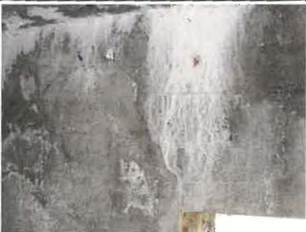
CuGa0 Mur de culée gauche Bex T2110 Fissures importantes supérieures à 0.3 mm A l'intérieur du couloir de visite, vers porte d'accès. Fissures en biais aux angle supérieur gauche et inférieur droit de la porte d'accès.
