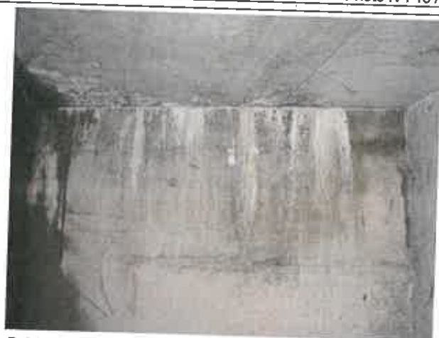
CuDr0 Mur de culée droit Bex 301 Zones humides A l'intérieur du couloir de visite. Trace d'humidité et efflorescences sous dalle.
