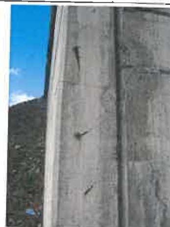
Cu6 Culée côté Massongex 2205 Armature fortement corrodée Banc de culée, face extérieure. A l'angle avec CuGa6. Eclats de béton avec armatures apparentes et corrodées.
