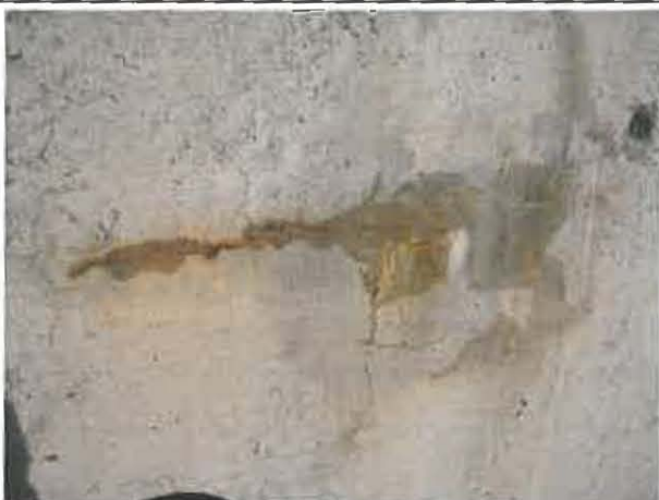
CuGa0 Mur de culée gauche Bex 301 Zones humides A l'intérieur de la culée, au pied du mur. Traces d'humidité dans les fissures.
