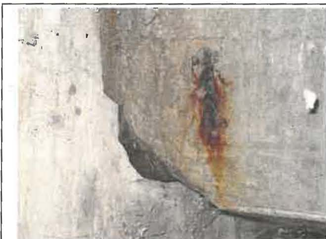
Ta Dalle supérieure du caisson 2205 Armature fortement corrodée A l'extrémité du tablier, dans le couloir de visite de Cu0. Eclat de béton avec armature apparente et corrodée à l'angle inférieur gauche du tablier.
