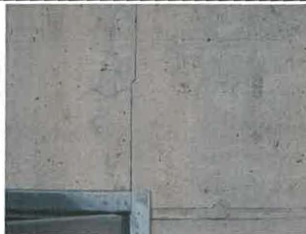
CuGa0 Mur de culée gauche Bex T2110 Fissures importantes supérieures à 0.3 mm A l'extérieur de la culée, aux angles de la porte d'accès. Fissures horizontales et verticales aux angles supérieur droit et inférieur gauche.
