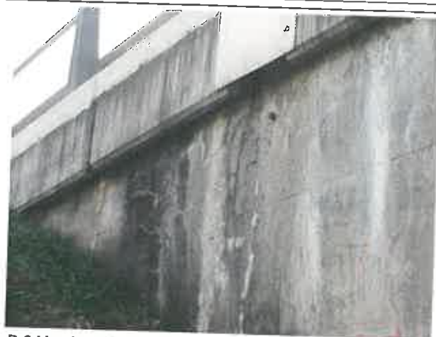
CuDr0 Mur de culée droit Bex 301 Zones humides A l'extérieur de la culée. Traces importantes d'humidité au droit du joint de chaussée avec efflorescences.
