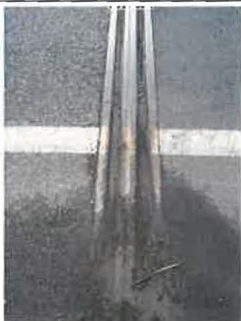
Jo6 Joint de chaussée Massongex T3201 Joint de chaussée détérioré Face supérieure du joint. Joint encrassée surtout aux extrémités gauche et droite.
