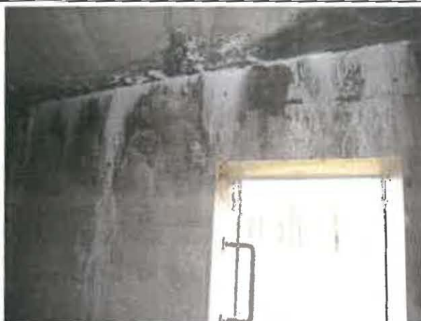
CuGa0 Mur de culée gauche Bex 301 Zones humides A l'intérieur du couloir de visite. Sous dalle. Traces d'humidité, efflorescences sur toute la largeur du mur.
