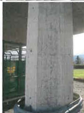
PiDr5 Pile 5 droite 1322 Ecaillages, cloques Face Massongex-Lausanne. Ecaillage de la surface de béton.
