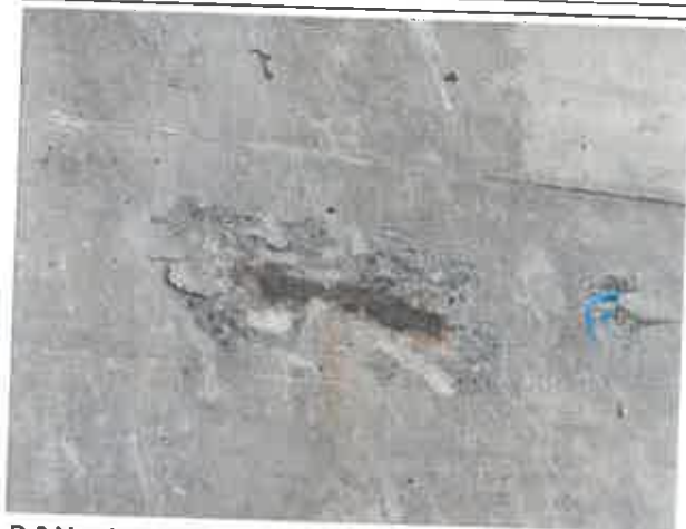
CuDr0 Mur de culée droit Bex 2205 Armature fortement corrodée A l'extérieur de la culée. Vers l'angle avec Cu0, partie supérieure du mur. Epaufure, éclat de béton avec armature apparente et fortement corrodée.
