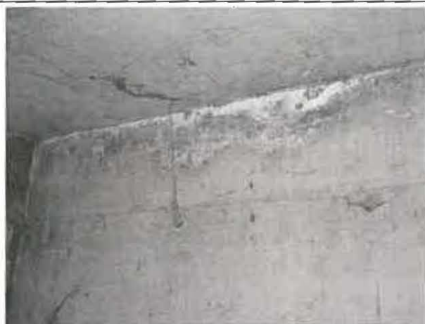
Cu0 Culée côté Bex 301 Zones humides Mur arrière de culée, à l'intérieur du couloir de visite. Sur le côté droit, sous dalle. Trace d'humidité, efflorescences.
