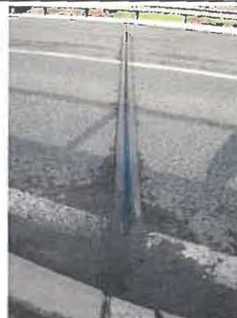
Jo0 Joint de chaussée Bex T3201 Joint de chaussée détérioré Face supérieure du joint. Joint encrassé, surtout vers les extrémités gauche et droite.
