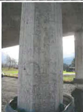
PiDr4 Pile 4 droite 1322 Ecaillages, cloques Face Massongex-Lausanne et face Lausanne. Ecaillage de la surface de béton.
