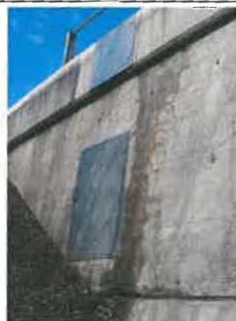
CuGa6 Mur de culée gauche Massongex 301 Zones humides A l'extérieur de la culée, au droit du joint de chaussée. Importantes traces d'humidité.
