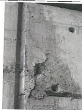
Cu6 Culée côté Massongex 1322 Ecaillages, cloques Banc de culée, face extérieure. A l'angle avec CuGa6. Eclat de béton avec armature apparente et légèrement corrodée.
